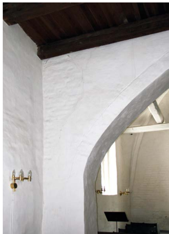
Fig. 32. Fortandinger til hvælv i skibets sydvestre hjørne (s. 2697). Foto Martin Wangsgaard Jürgensen 20132. – Vault tothing in the southwestern corner of the nave.
