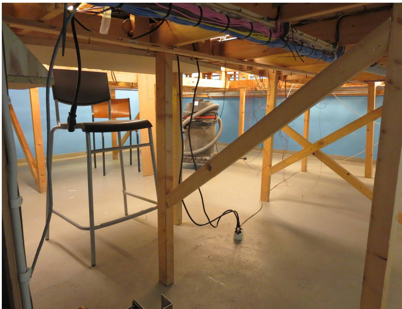
"Enkelte" ledninger skal der til for at få vores anlæg til at virke! Overalt ser man vidnesbyrd om Bents fornemme el-arbejde. Vi er under Sukkerkøbing station i rum 3.
